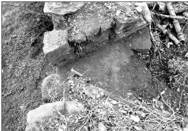
Obr. 27: Český Brod, koruna hradební kurtiny mezi brankou a jihovýchodní nárožní baštou během průzkumu před opravou. Detail jedné ze střelnic (foto Vladislav Razím, 1998).
